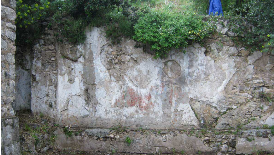
Figura 34 Il muro della chiesa posto a nord. Evidente la presenza di differenti strati di intonaco e di alcune tracce di pitturazione (Foto F. Comes 2013)
